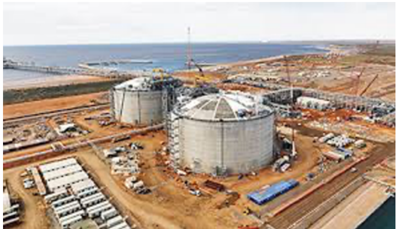
Wheatstone LNG Tanks
